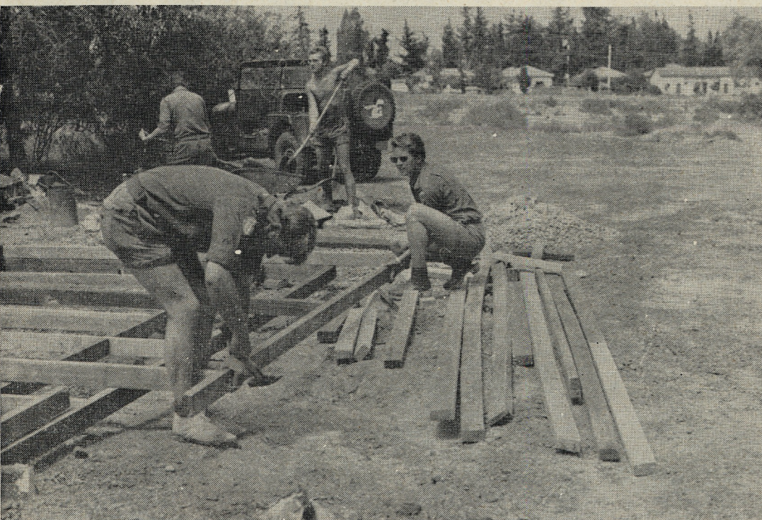
■ Efter støbningen skal væggene rejses. "Tømmerne", som her er i gang med arbejdet, er KS K.O. Jørgensen og KS P.B.B. Poulsen.
